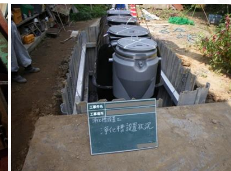
▶合併処理浄化槽
