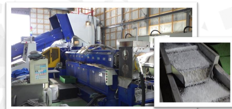
▶ 廃プラスチック類のリサイクル処理施設
