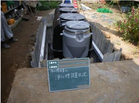
▶ 合併処理浄化槽
